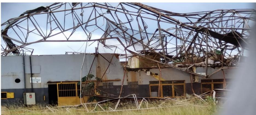
Interior do Imóvel – Fevereiro.2023 – Foto tirada a partir de um buraco no muro
